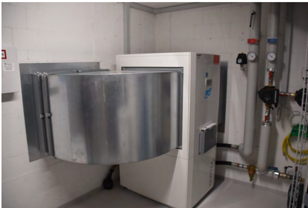
Technikraum im EG
