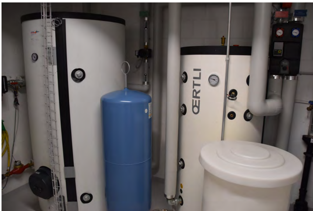
Technikraum im EG
